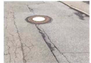
Netzrisse und Kornausbrüche, u. a. zurückzuführen auf Ausmagerungen der alten Straßenoberfläche.
