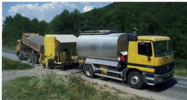
Sehr wirtschaftlich arbeiten die von schäfer technic angebotenen Reparaturzüge, bestehend aus einem Spezial-Sattelaufleger-Fahrgestell für den Bindemittelbehälter (12.000 Liter) und dem nachgeordneten Anhänger. Mit Hilfe eines ausfahrbaren Ladebandes kann der Splitt direkt vom Kipper in den Splittbunker befördert werden.
